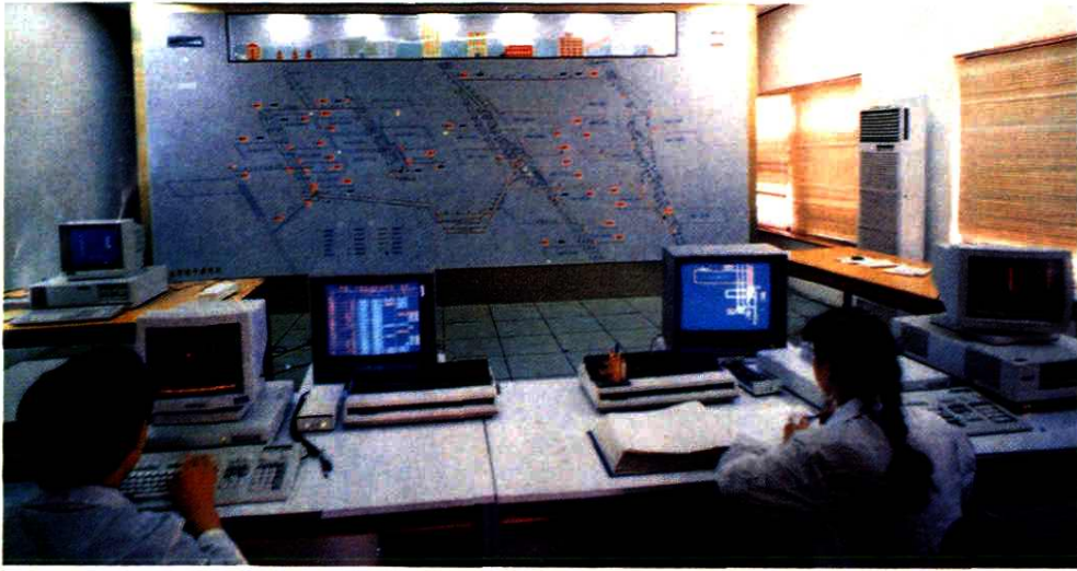
矿井安全监测系统
