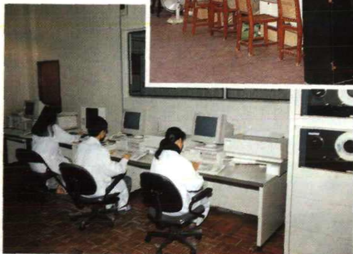
程控机房一角
