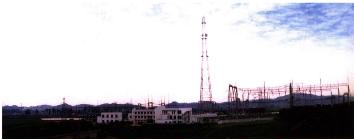
1992年12月开工、1995年建成投运的500千伏柳州沙塘变电站
