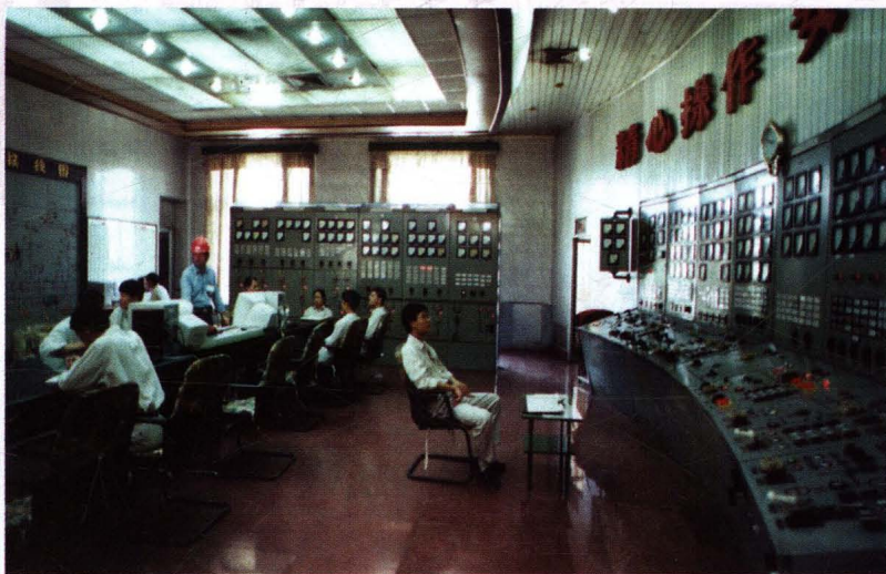
2001年8月, 扩建中的合山火电厂中控室
