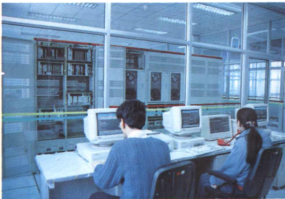
7000门程控交换机房
