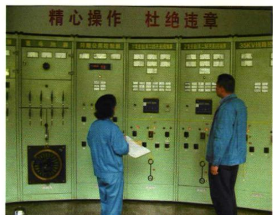
开机后监视设备运行情况
