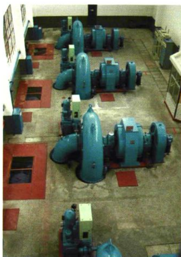
车坝一级电站发电生产机组
