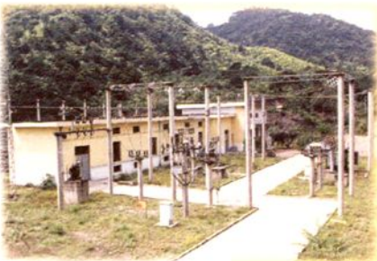
《 台矿10千伏配电所
