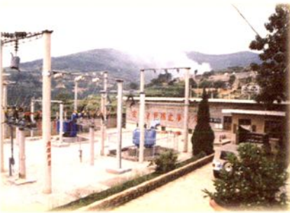
《 关王庙35千伏变电站
