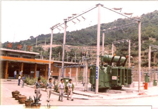
《 台头110千伏变电站
