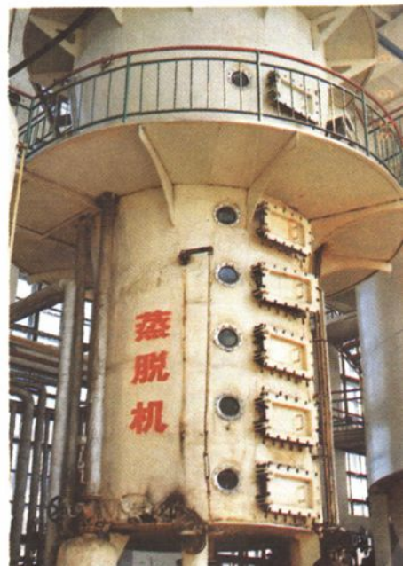
16. 巴彦县兴隆制油厂主车间蒸脱机
