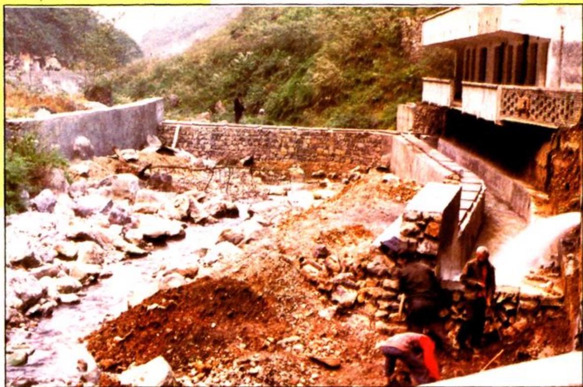
▲ 山虎关水库管理局白马供水厂源头
