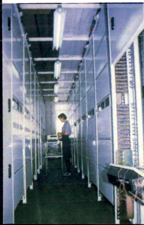
泗水电信局程控机房
