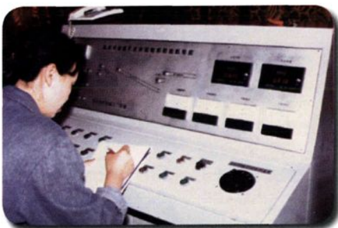
主井运输系统电控台
