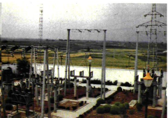
35KV 张集变电站
