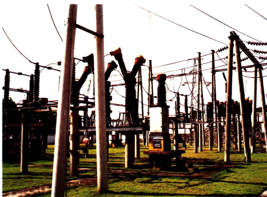
▲ 110千伏县中心变电站（飞鹅亭变电站）
