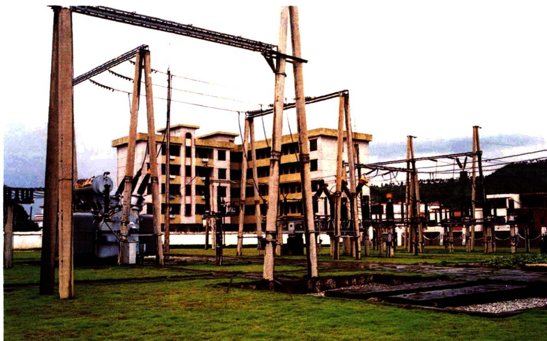
▲ 110千伏天堂变电站
