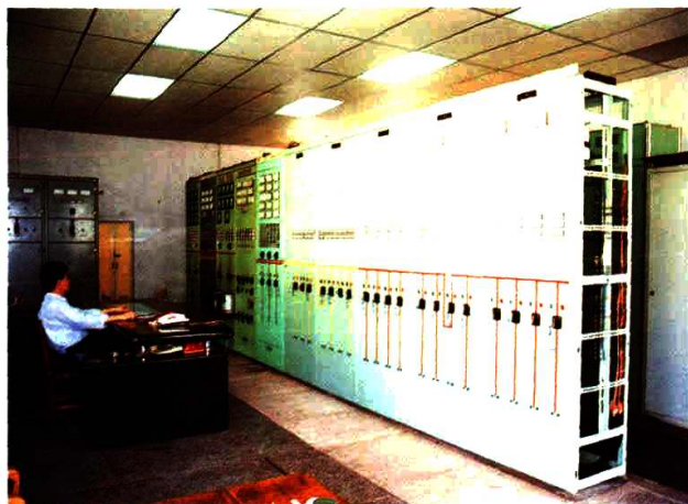
▲ 110千伏县中心变电站控制室
