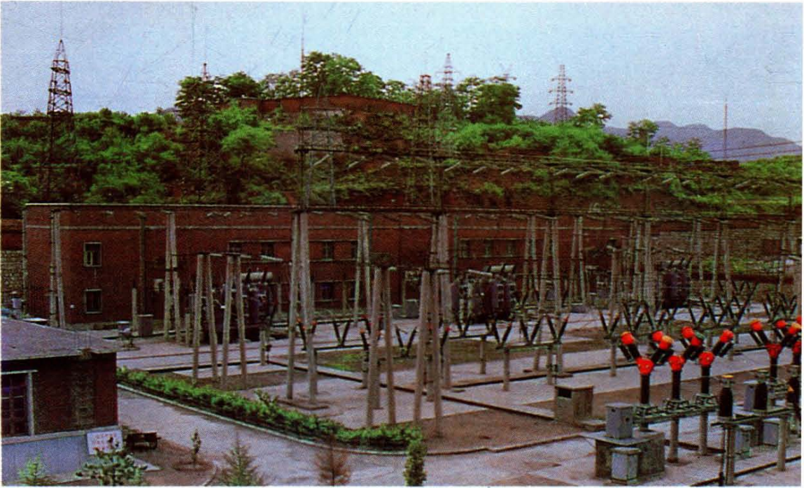
矿区供电枢纽——110KV降压站。
