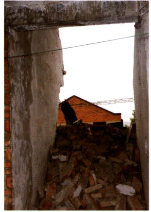
受震垮塌的房屋
