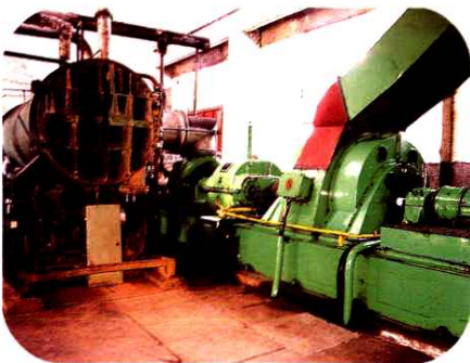
雷甸热电厂 1500 千瓦发电机组
