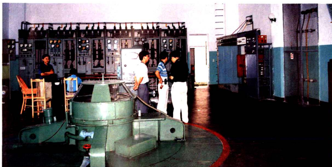
对河口水电站 1360 千瓦发电机组
