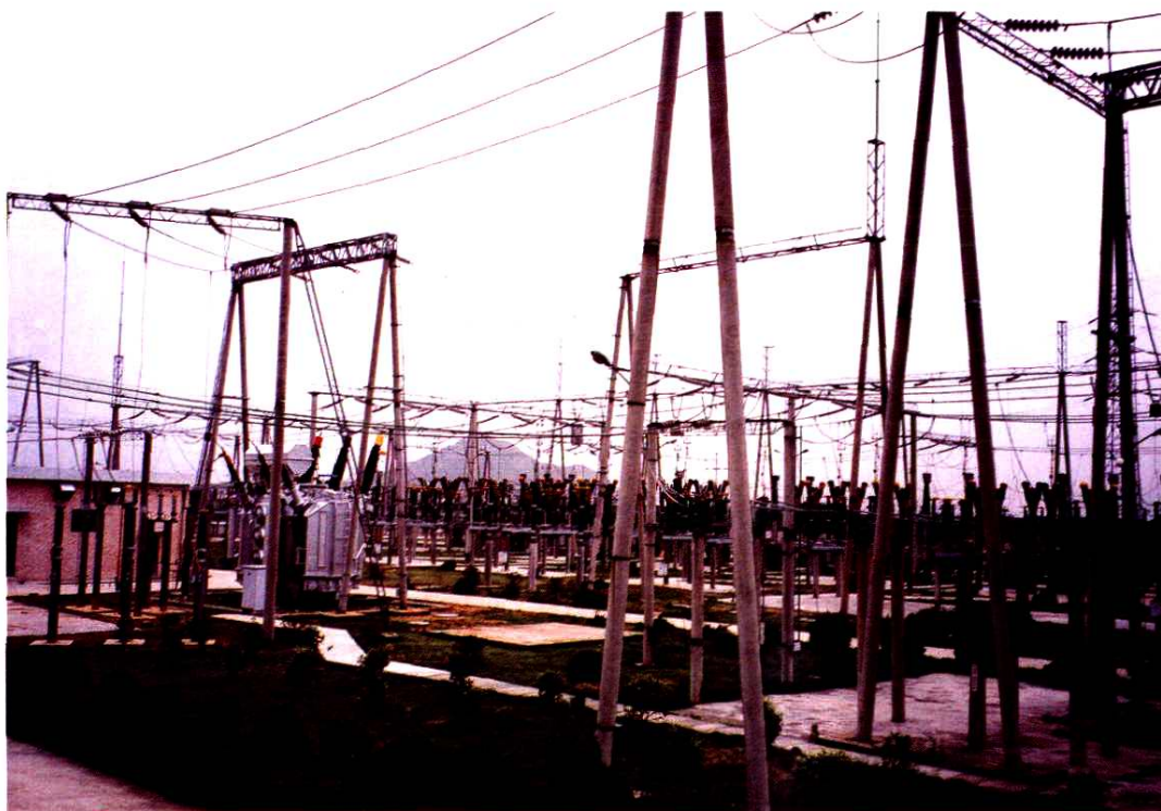
220 千伏莫梁变电所户外设备全景
