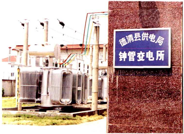
35 千伏钟管变电所一角
