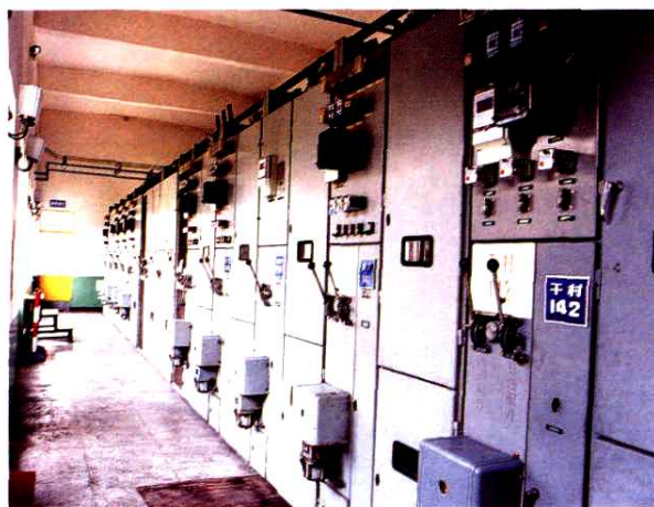
35千伏千山变电所10千伏开关室
