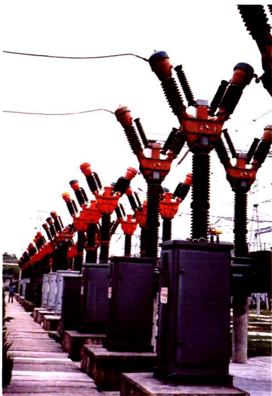
220 千伏莫梁变电所220 千伏断路器
