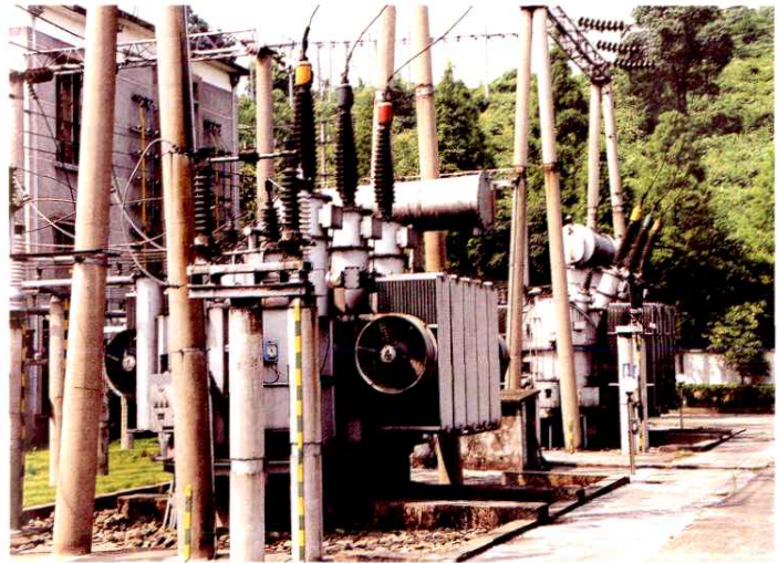
110 千伏德清变电所 2 台 31500 千伏·安主变压器
