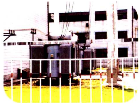
湖州加怡新市热电有限公司 8000 千伏·安升压变压器
