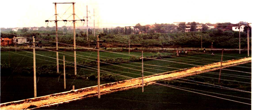
35 千伏德雷输电线路
