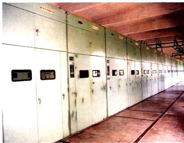
110千伏新市变电所35千伏户内开关室
