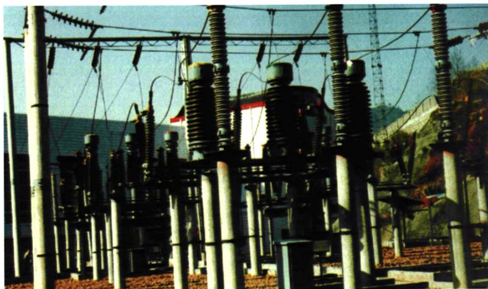
地面式升压开关站, 占地面积1764平方米, 于1999年2月建成
