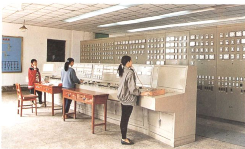
▶ 现代化的供电调度中心
