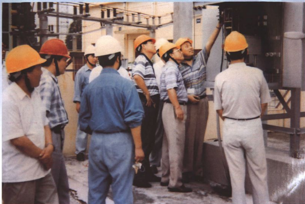
1997年7月16日，华东电管局、江苏省电力局创一流供电企业检查组在110千伏扬中变电所检查35千伏断路器机构箱
