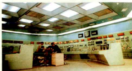
核电站集控室
