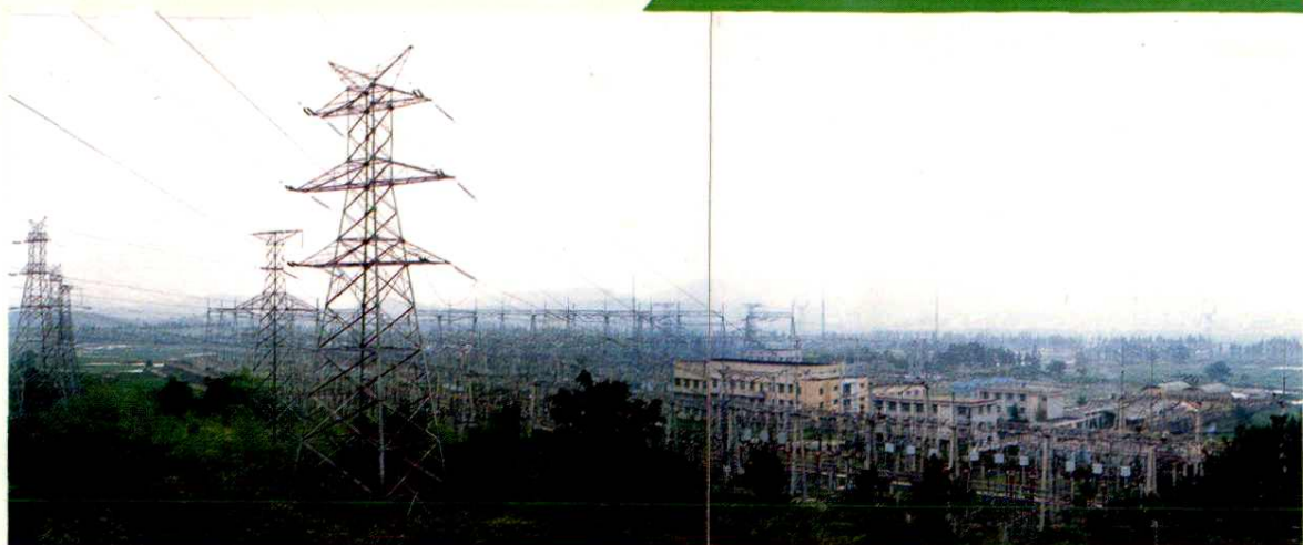
全省第一座 500 千伏瓶密变电所全景
