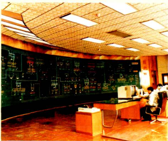
嘉兴电力局调度室
