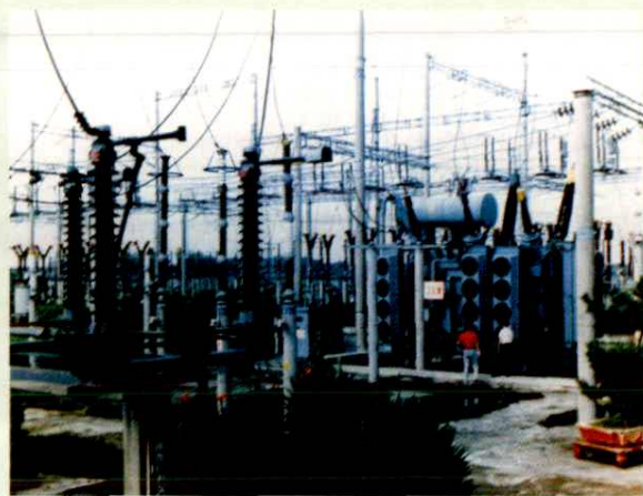
连接浙沪的 220 千伏南湖变电所
