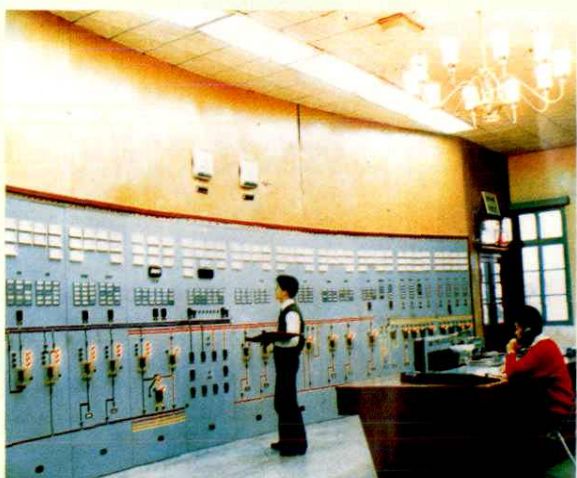
湖州电力局调度室
