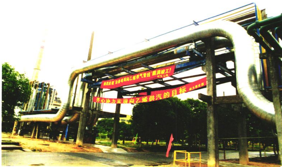
2001年12月26日，自备热电站向乙烯供汽管线投用。
