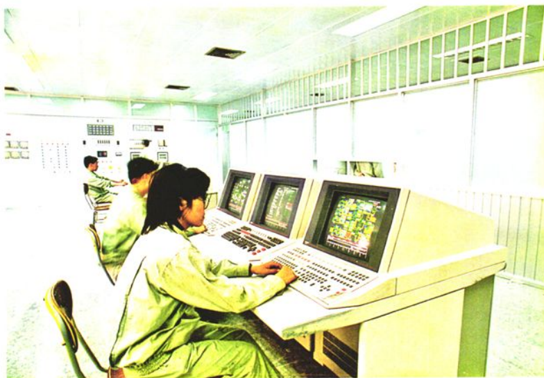
催化裂化(一)装置 主控室(2001 年)
