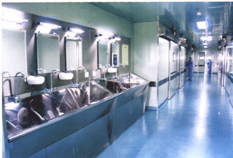
现代化洁净手术室
