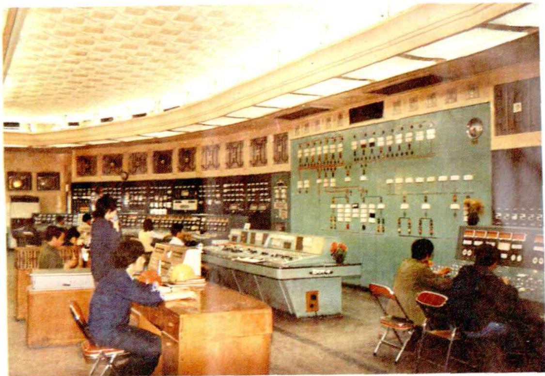
二电厂集控室
