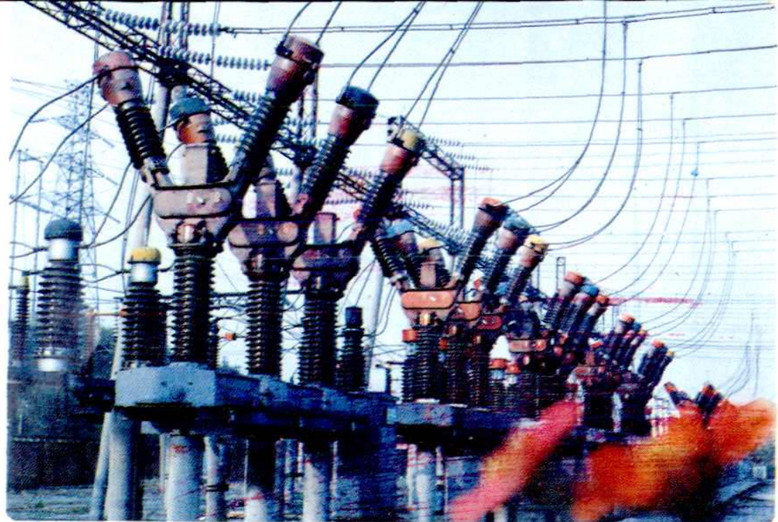
二电厂升压站
