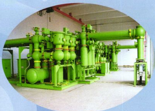
1997年，无锡第一座110千伏全户内变电所：车站变电所六氟化硫开关
