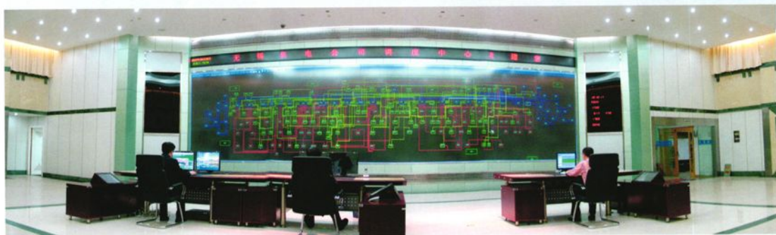
无锡电网调度中心(2002年摄)
