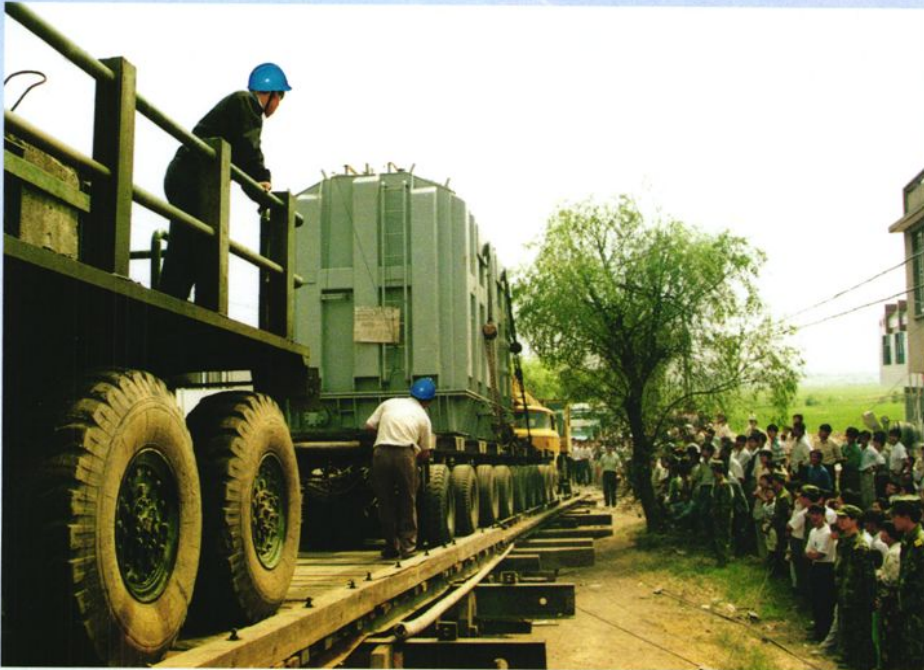
220千伏石塘湾变电所18万千伏·安主变压器在运输途中(1999年摄)
