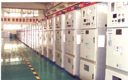
全国第一台核电开关柜(川开集团)
