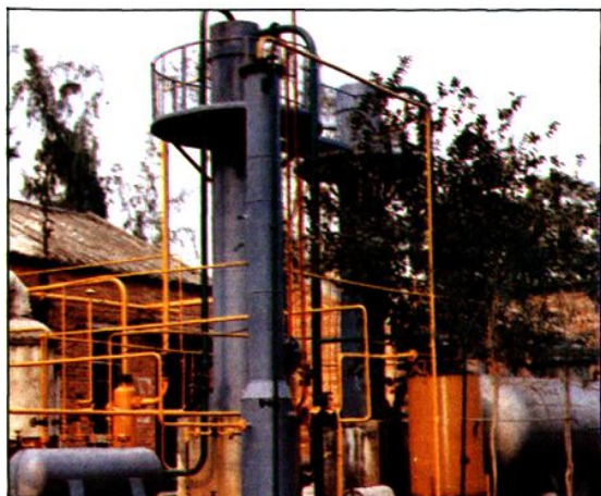
制冷系统外景
