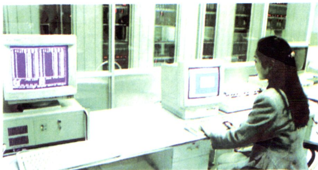
南充县邮电局通信程控室
