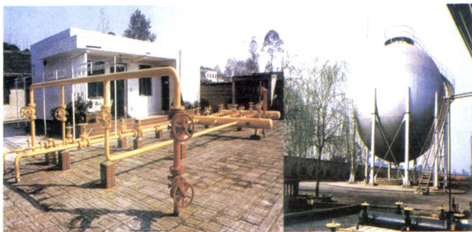
南充十里工业街天然气配气站
