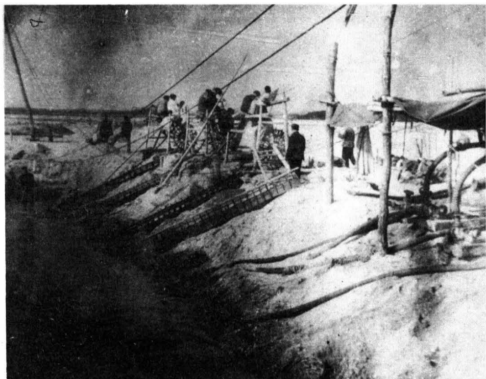
民兵建设 师团自制的土 抽水机和电动 排灌机正在全 面排水，以保 证全面开挖基 础。
