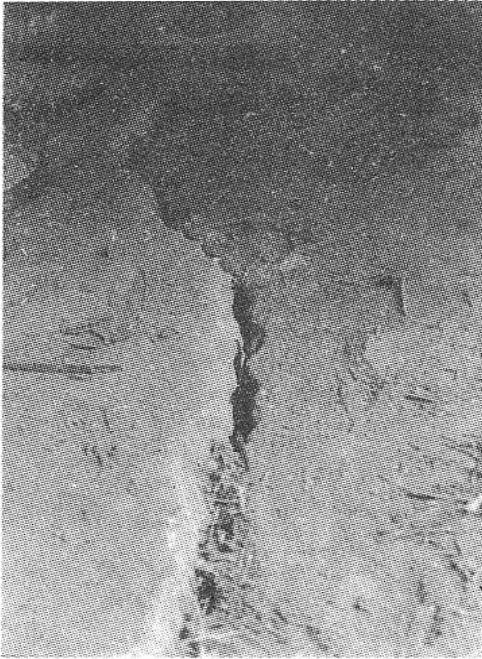
大明宫抽水站库房。房内水泥地面裂缝呈锯齿状沿北东 50^{\circ} 方向延伸，缝宽2厘米，垂直错距4厘米，南低北高，显示垂直张扭性特征。（镜向：北东）
