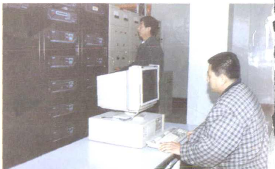
调测电力设备
