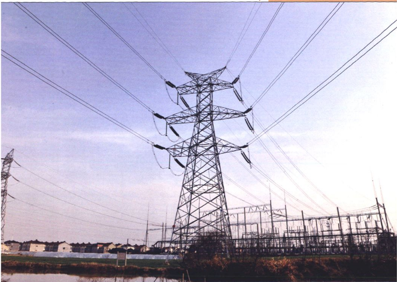
220千伏双回耐张塔(摄于2002年3月)
