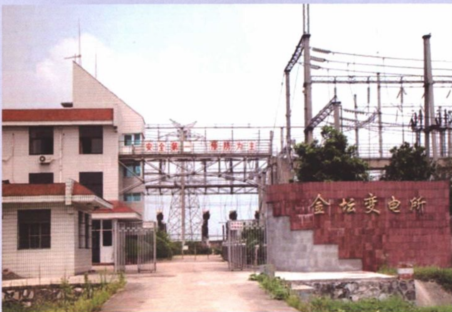
1992年6月30日, 220千伏金坛变电所竣工投运
