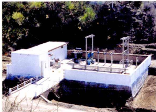
35千伏输变电站
