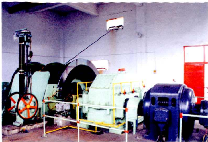
45万吨矿井主提升机
