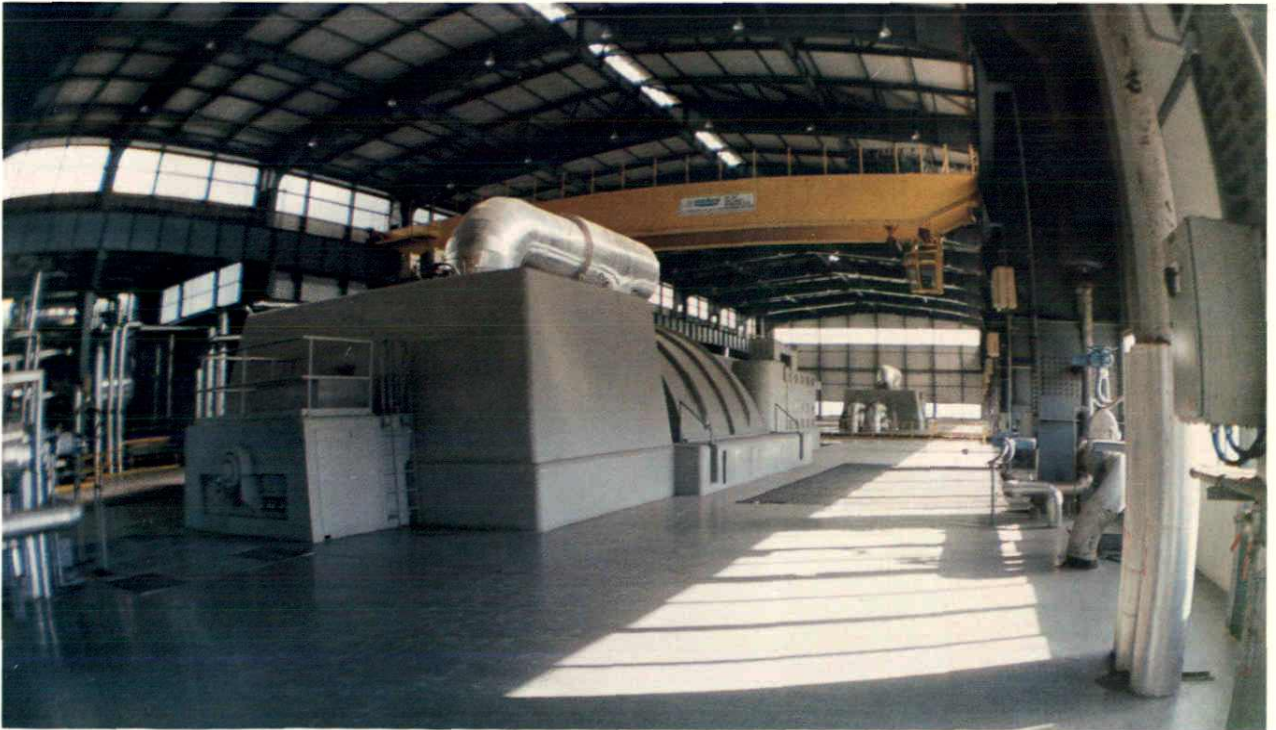
21 华能上安电厂,1990年1期工程建成,投产2台35万千瓦进口机组(郭立秋供稿)
