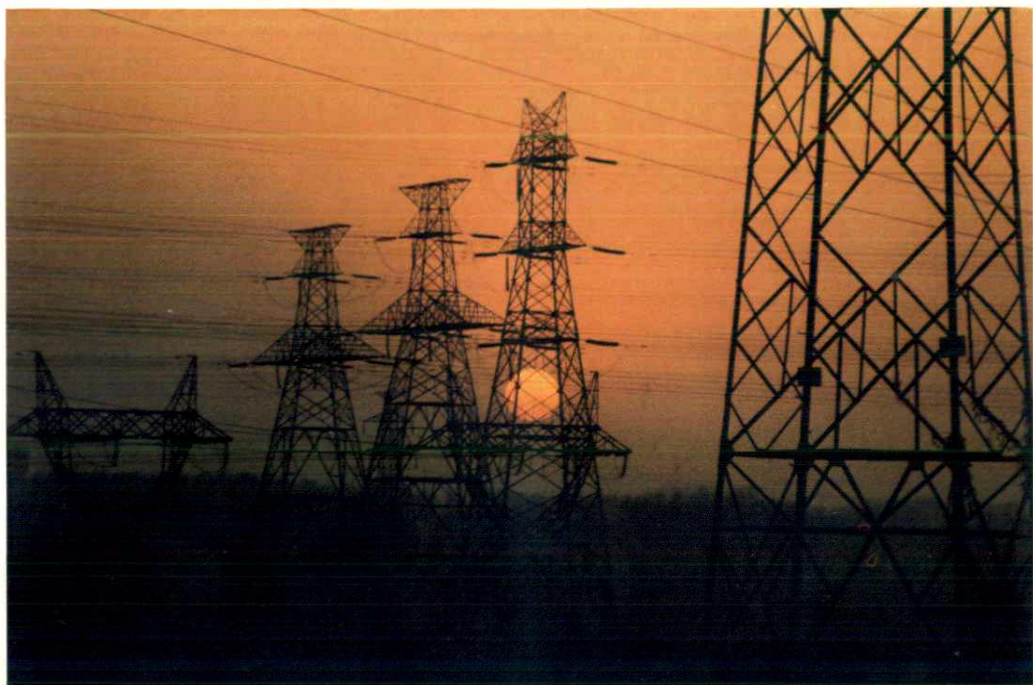
32 塔群(唐山供电局供稿)
