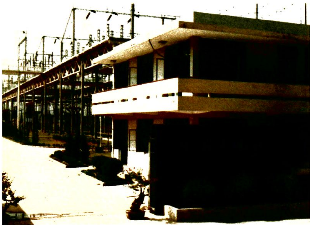
500 千伏繁昌变电所
