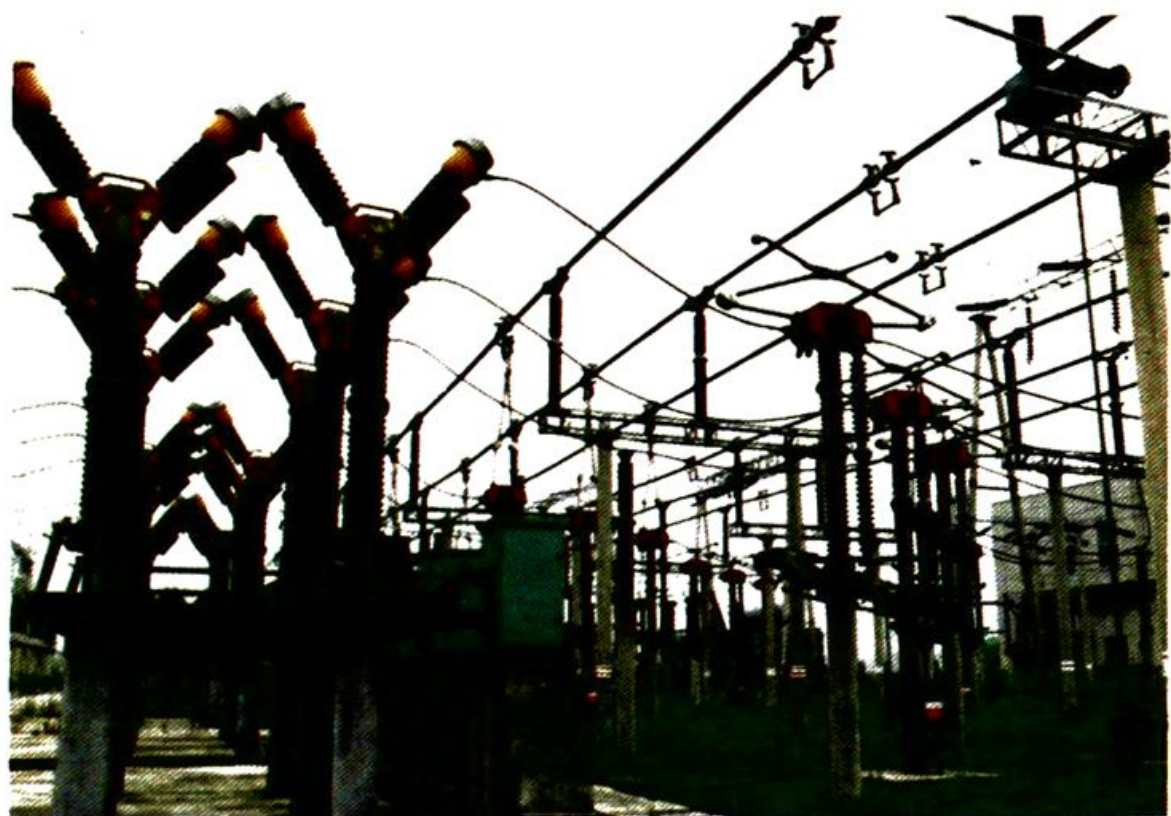
220千伏火龙岗变电所管型母线
