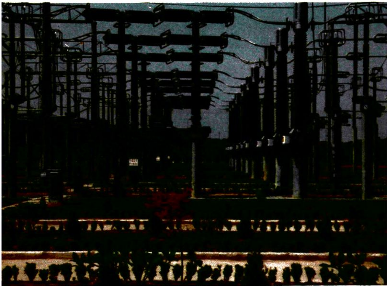
500 千伏 繁昌变电所六氟化硫开关
