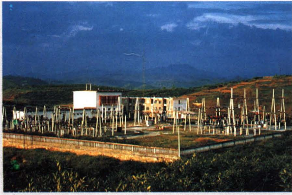
松桃110kV变电站外景, 主变 容量 1 \times 1 万kVA
