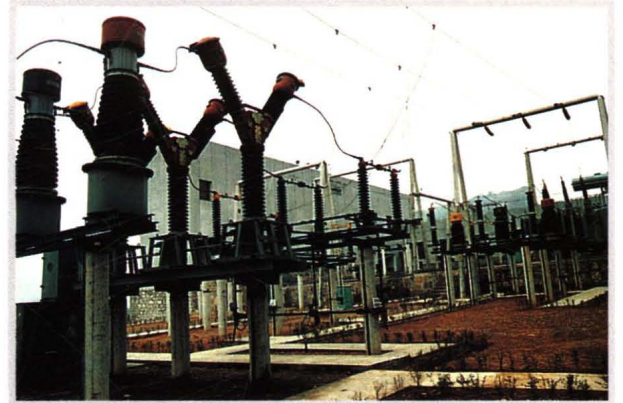
思南110kV变电站外景, 主变 容量 1 \times 3.15 万kVA
