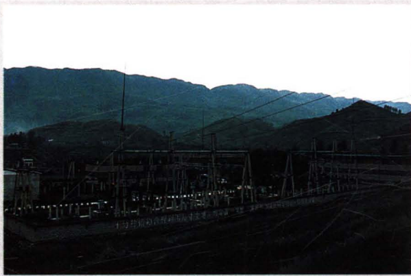
印江110kV变电站外景, 主变 容量 1 \times 1 万kVA
