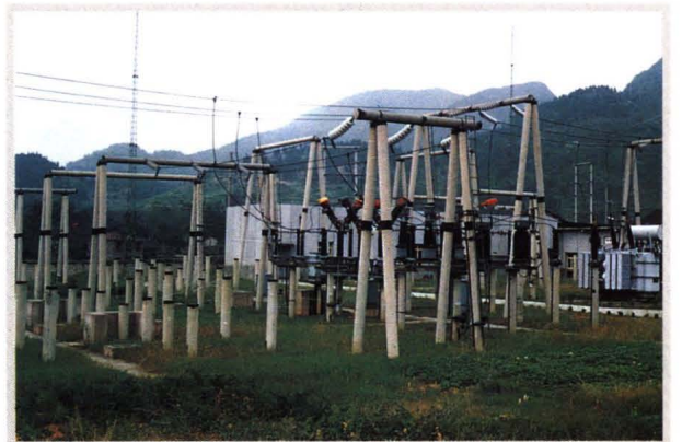
江口110kV变电站外景, 主变 容量 1 \times 2 万kVA
