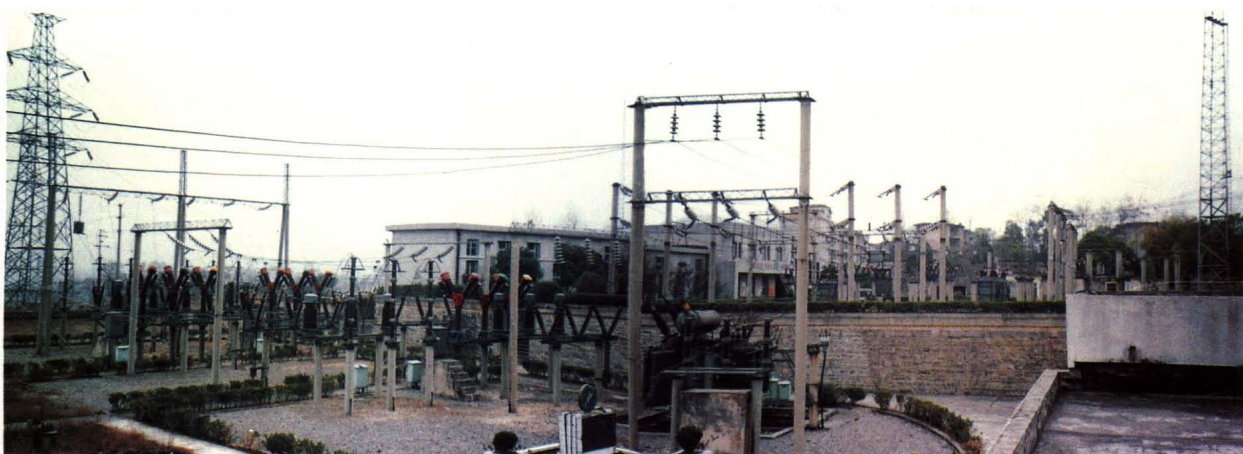
铜仁市浅滩110kV变电站外景, 主变容量 2 \times 1 万kVA
