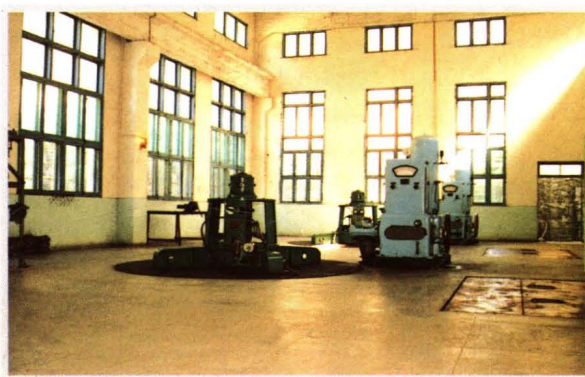
印江甘金桥水电站主厂房内发电 机层, 装机 2 \times 1600 kw
