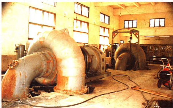
印江合水水电站主厂房内发电机层, 装机 2 \times 500\text{kW}
