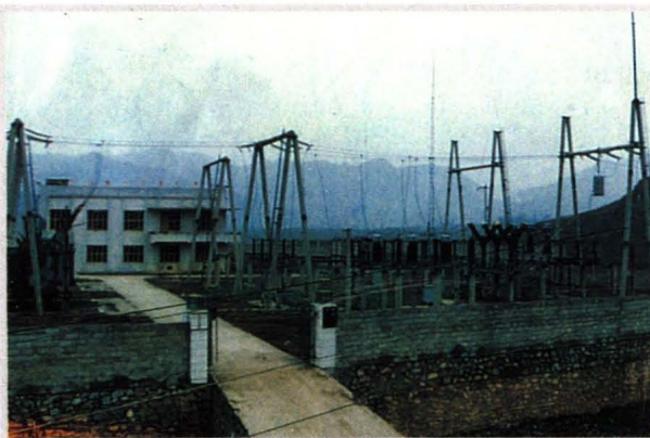
德江110kV变电站外景, 主变 容量 1 \times 1.6 万kVA
