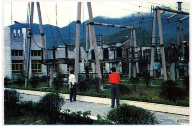
石阡110kV变电站外景, 主变 容量 1 \times 1 万kVA
