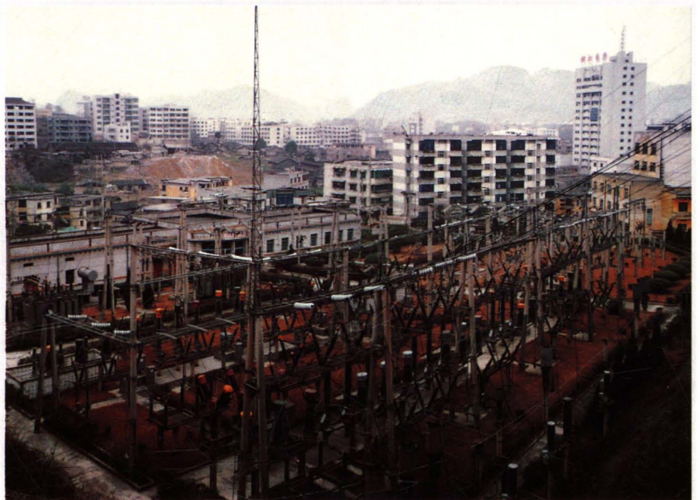
铜仁(黑松塘)110kV变 电站外景,主变容 量 2 \times 2 万kVA
