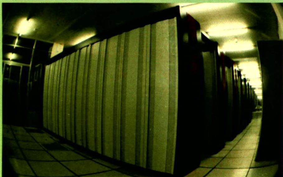
岳阳市邮电局程控电话交换中心
