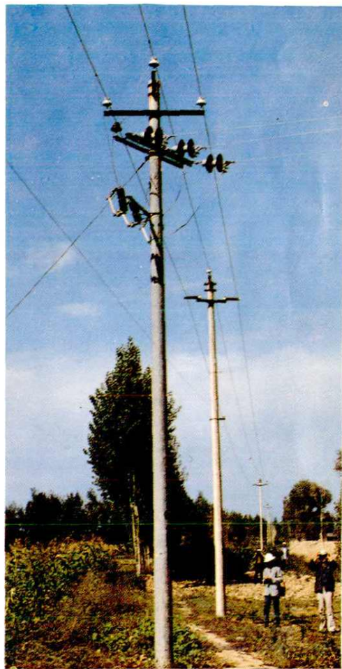
10KV配电线路
