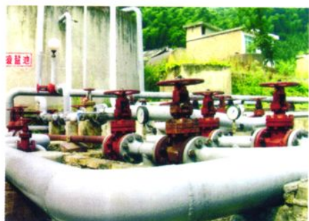
四丰盐化公司液盐池管道
