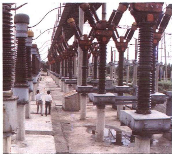
建于 1980 年的 220 千伏九里变电所一角
