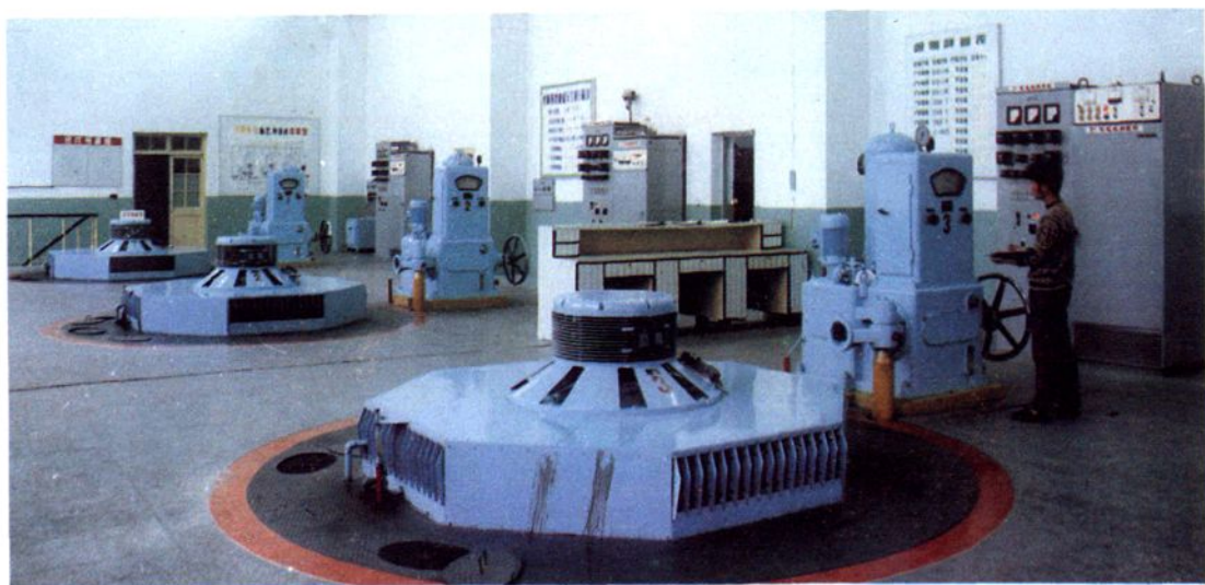
建于1980年的新昌县 长诏水电站机房
