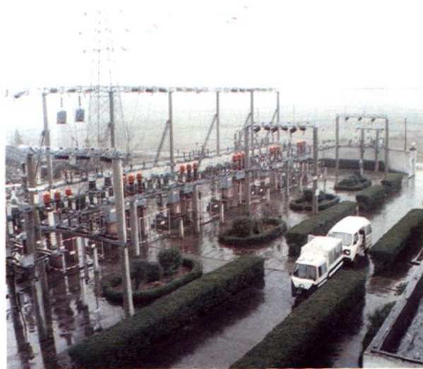
35千伏绍兴平水变电所
