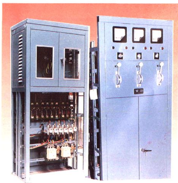
集体企业绍兴电气承装公司制作的低压开关柜
