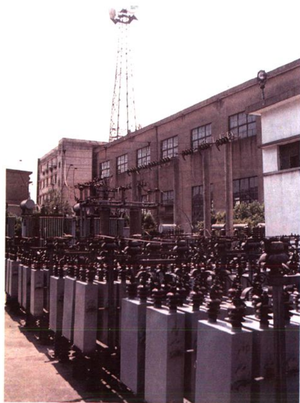
系统试验站串联电容器试验现场
