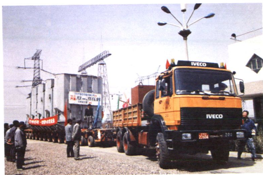
重运公司运输大型变压器
