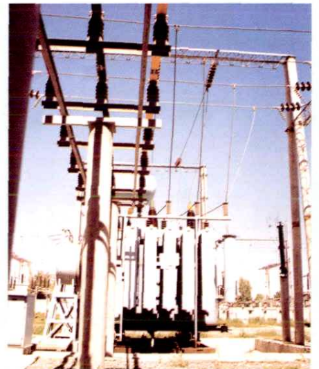
华能火电设备安装工程公司安装投运的 110 千伏变电站
