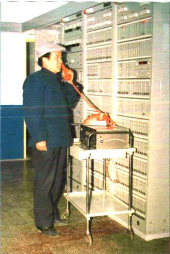
▲1990年全电子交换机房
