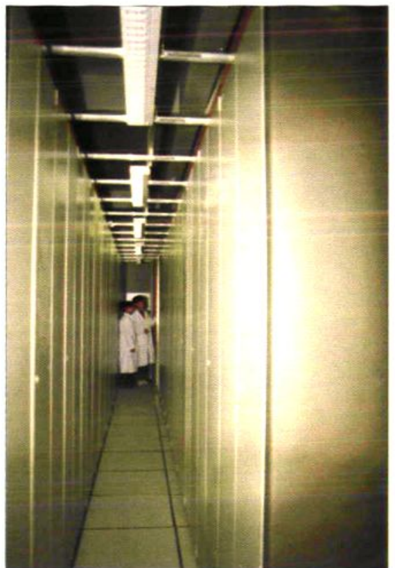
▲1996年县局程控电话交换机房
