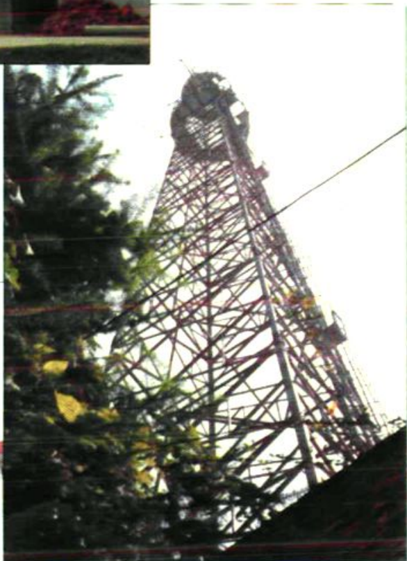
▶ 江背支局移动电话机站发射塔
