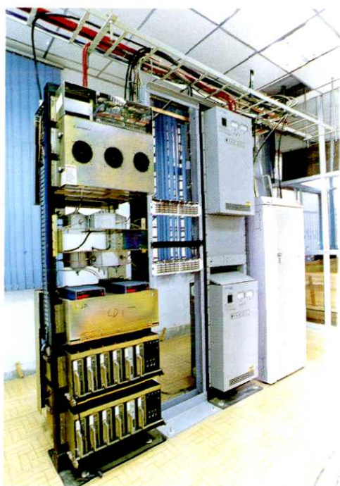
泗洲庙支局移动通信(大哥大)综合机房
