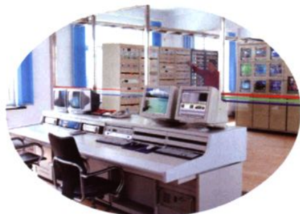
有线电视发射机房
