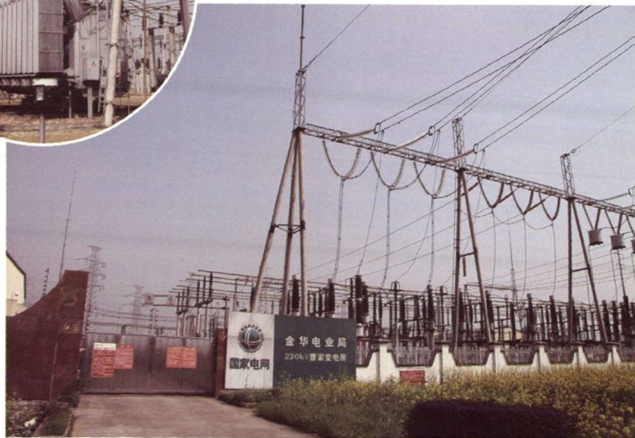
● 金华电网首座综合自动化 220 千伏变电所——曹家变电所
