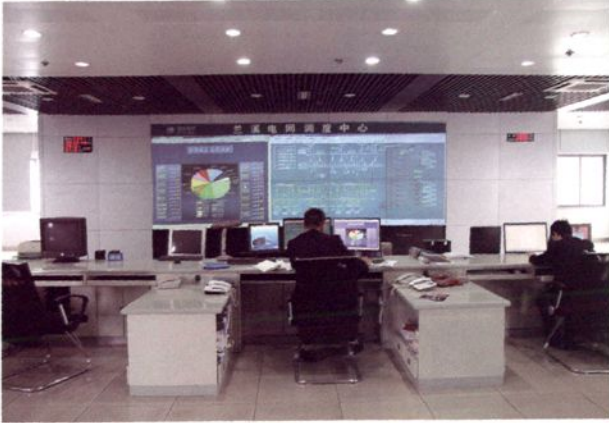
● 兰溪市供电局电力调度大厅
