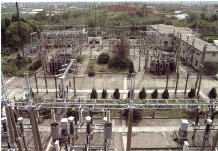
● 1971年建成的兰溪第一座110千伏变电所——兰溪变电所
