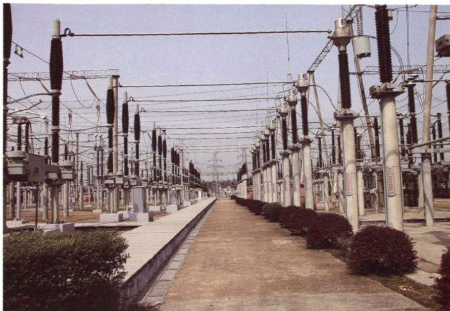
● 兰溪首座 220 千伏变电所——云山变电所
