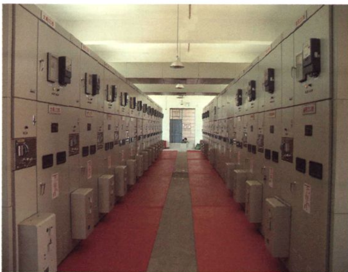
● 35 千伏城关变电所开关室
