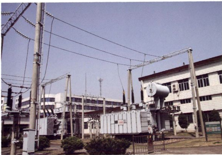
● 第一座城市110千伏变电所——中洲变电所
