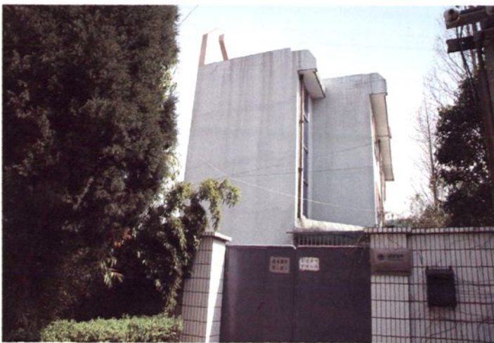
● 1995 年建成的首座 10 千伏开闭所——青湖开闭所
