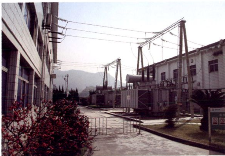
● 110千伏六洞山变电所
