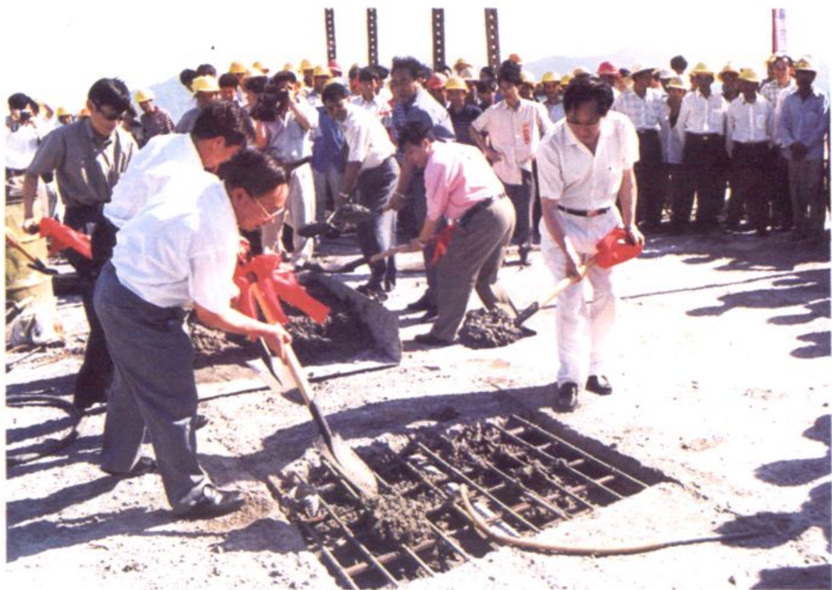
↑中共台山市委书记黎力行（左前）出席镇海湾大桥合拢仪式，并为全桥合拢注下混凝土。
