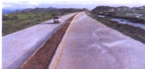
↓ 新台高速公路的浮石一级路段
