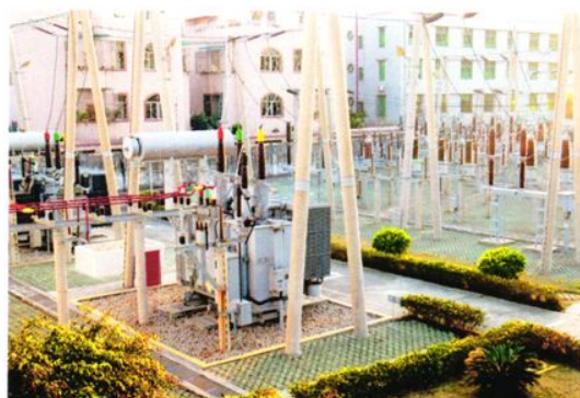
110 千伏澄海变电站（曾建一摄）
