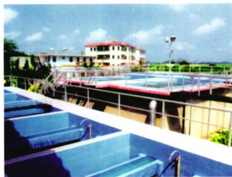
南洋自来水公司水厂（照片由澄海南洋自来水公司提供）
