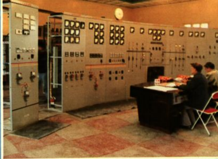
11万供电所总值班室
