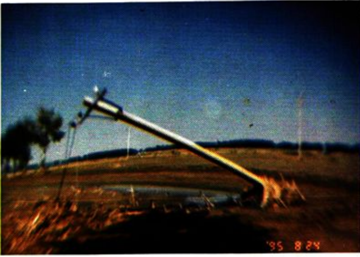
水泥通讯线杆被折断
