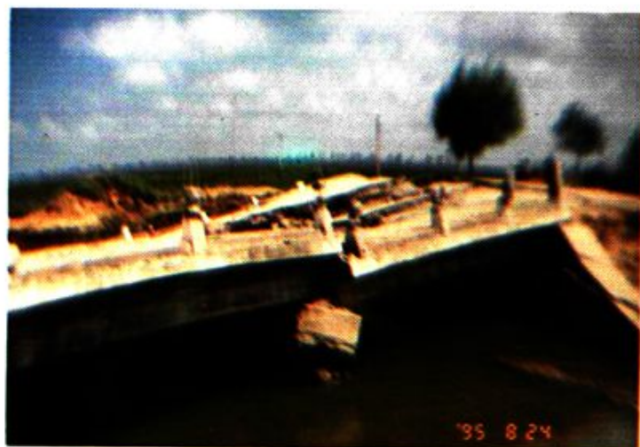
被冲毁的辽中茨榆坨桥
