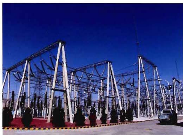
2004年1月10日，阿盟首座220千伏变电站投运
