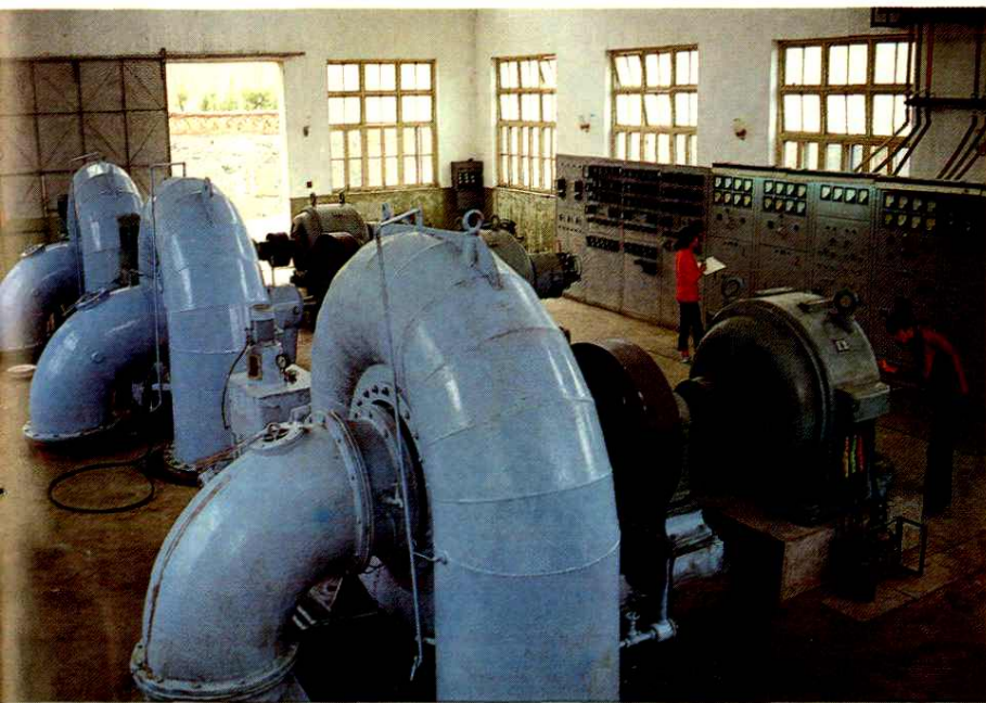
● 红寺坝电站机房
